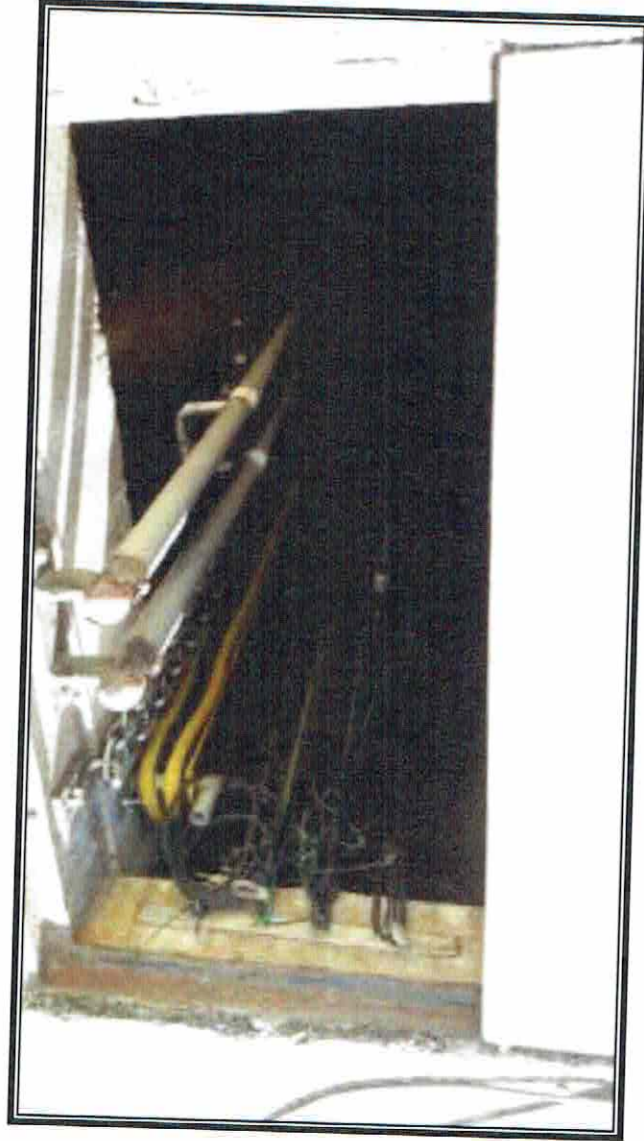
Figura 116: EEE-7/Final – Poços das Bombas. Fonte: PMSB.
