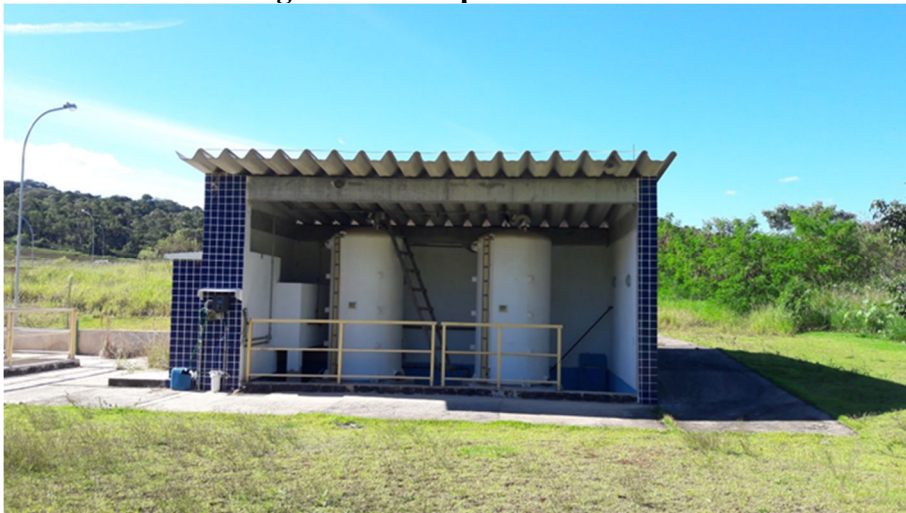
Figura 6.15: Depósito de Cloro
