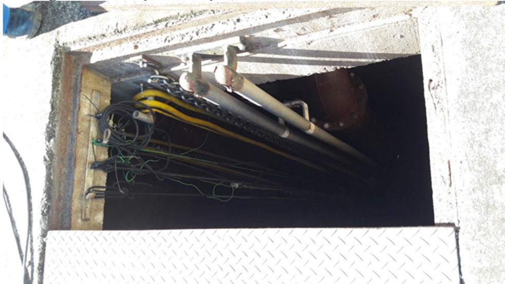
Figura 6.39: Poço de Sucção, Onde Estão Instaladas as Bombas
