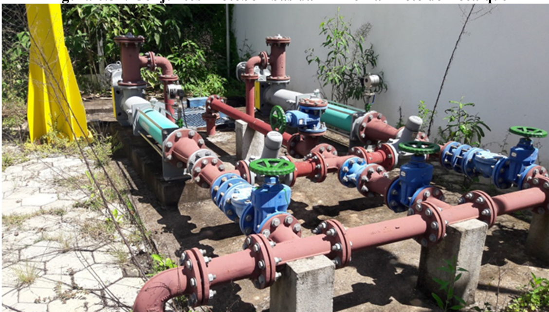
Figura 6.51: Conjuntos Motobombas da EEE e Barrilete de Recalque
