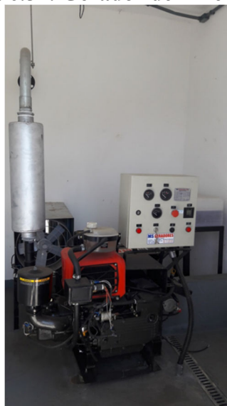
Figura 6.54: Gerador de Emergência
