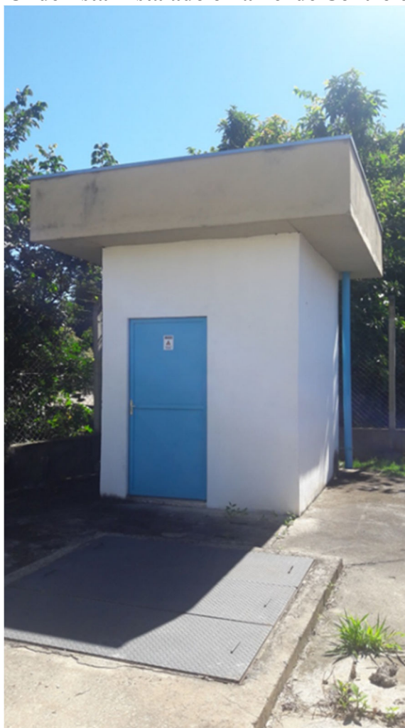
Figura 6.27: Edificação da EEE-3, Onde Está Instalado o Painel de Controle
