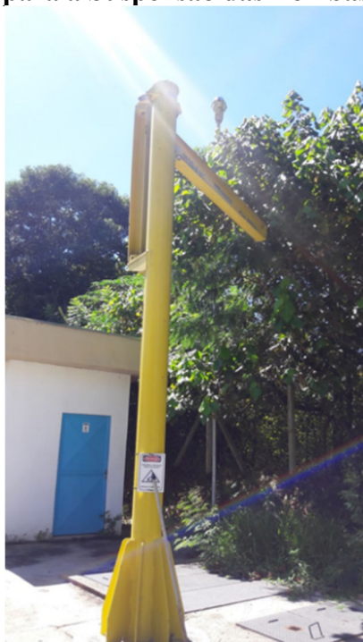
Figura 6.37: Equipamento (talha) para a Suspensão das Bombas
