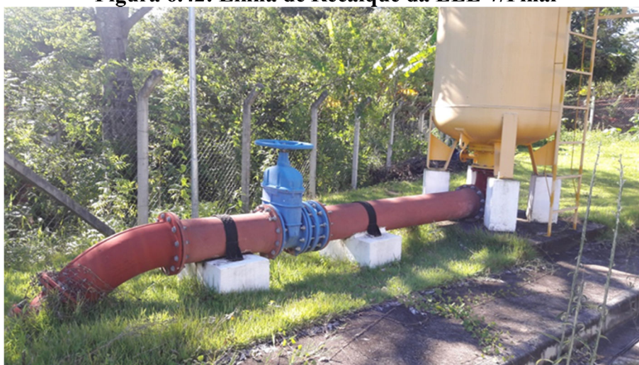
Figura 6.42: Linha de Recalque da EEE-7/Final
