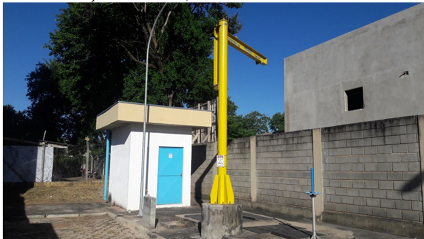
Figura 6.24: Edificação da EEE-2, Onde Está Instalado o Painel de Controle
