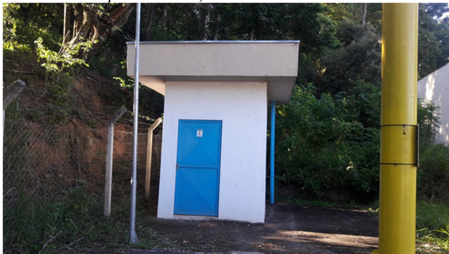
Figura 6.21: Edificação da EEE-1, Onde Está Instalado o Painel de Controle
