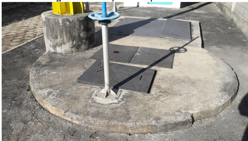
Figura 6.23: Poço de Sucção da EEE-2
