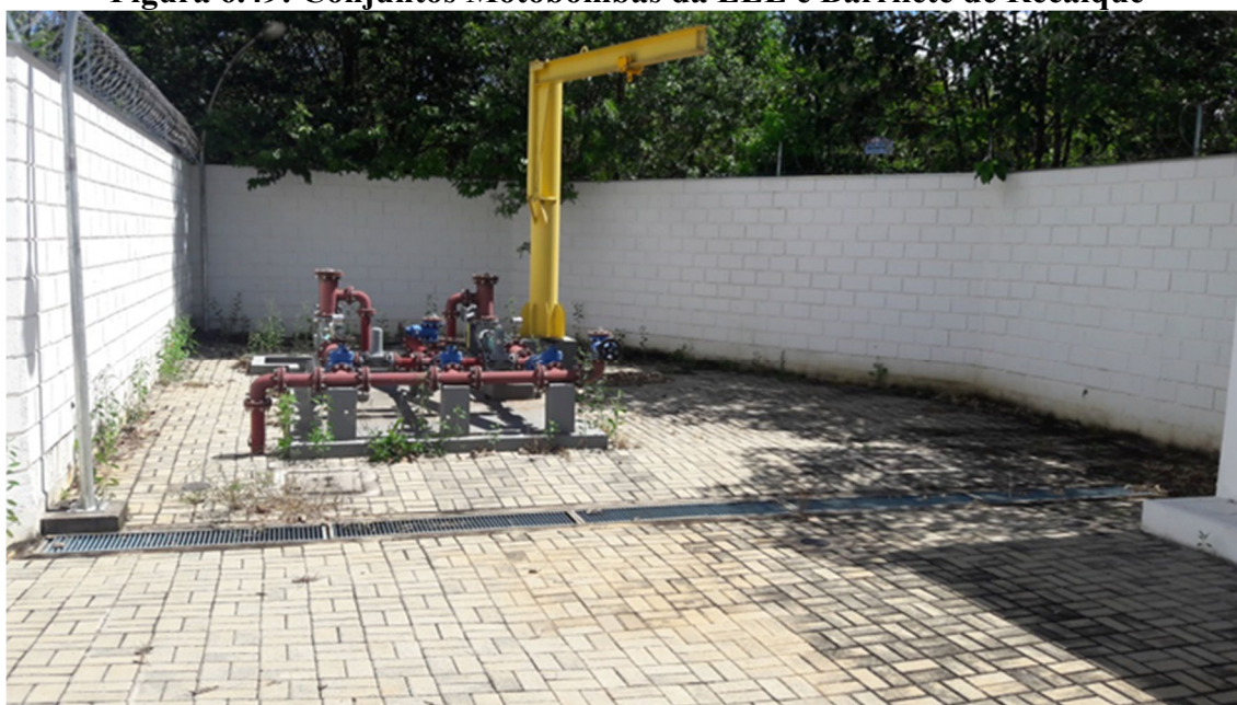
Figura 6.49: Conjuntos Motobombas da EEE e Barrilete de Recalque
