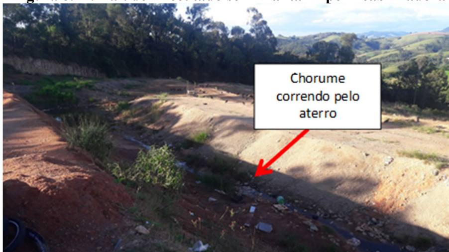
Figura 8.11: Talude Executado sem Manta Impermeabilizadora
