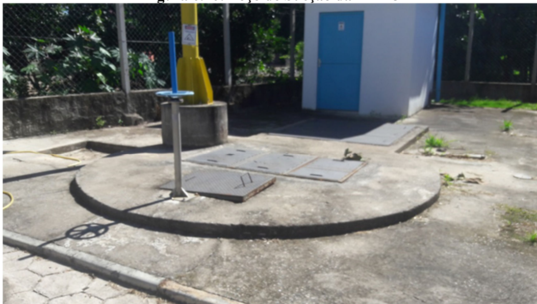
Figura 6.26: Poço de Sucção da EEE-3
