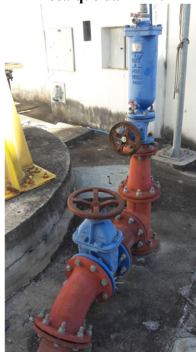
Figura 6.44: Barrilete de Recalque da EEE-9
