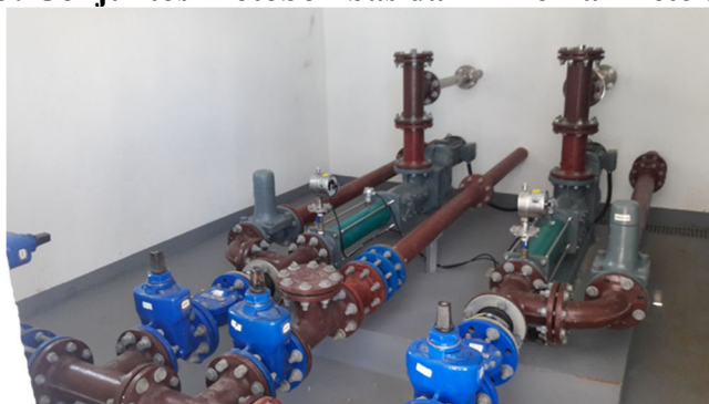
Figura 6.53: Conjuntos Motobombas da EEE e Barrilete de Recalque
