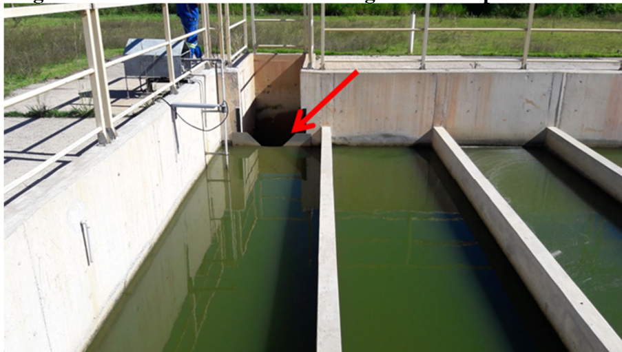
Figura 6.17: Vertedor na Saída do Esgoto do Tanque de Contato
