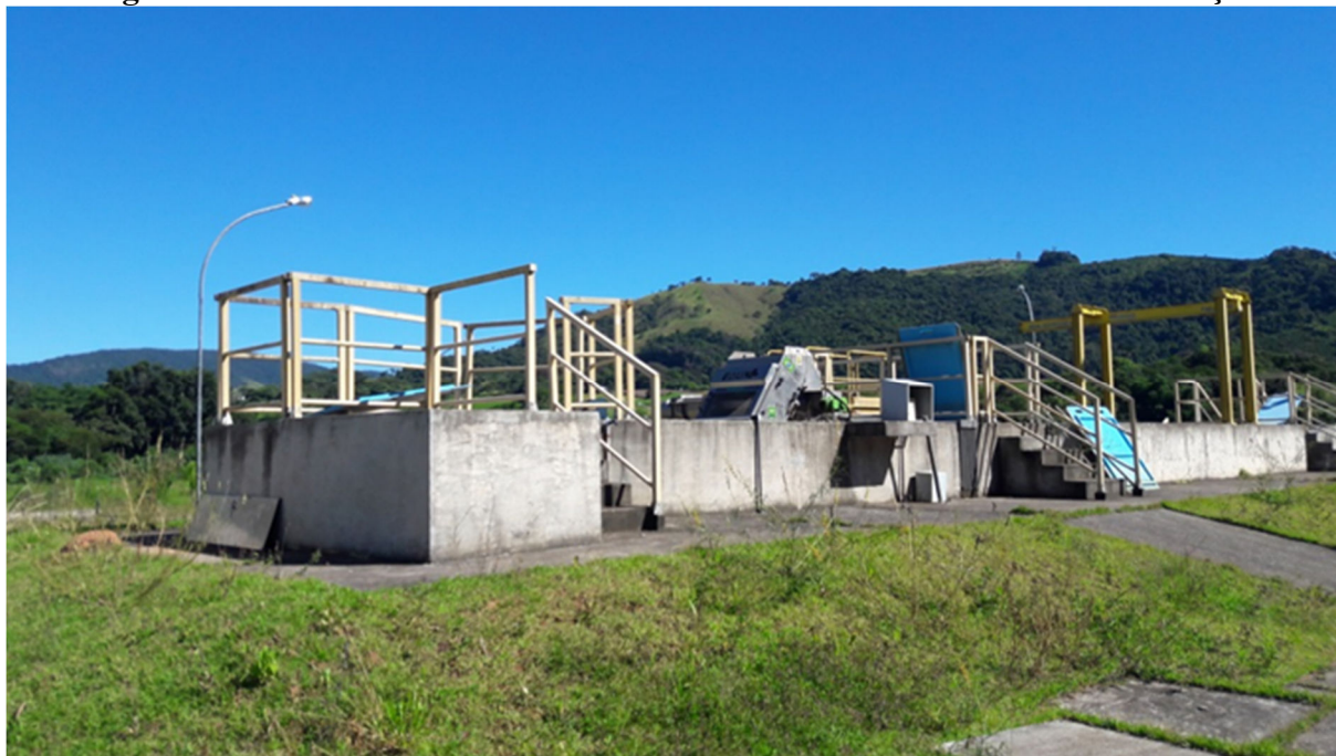
Figura 6.6: Estrutura Onde Estão Instalados o Gradeamento e a Desarenação
