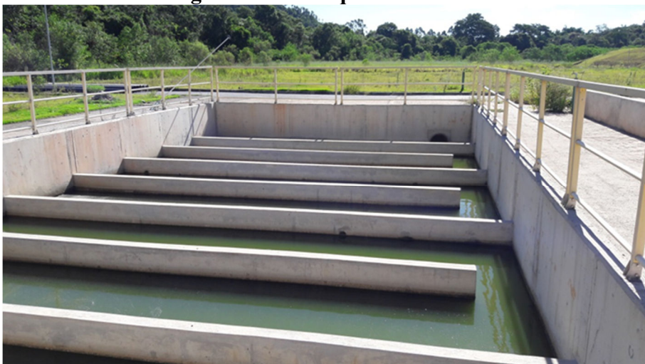
Figura 6.16: Tanque de Contato
