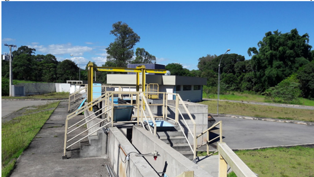
Figura 6.8: Estrutura Onde Estão Instalados o Gradeamento e a Desarenação
